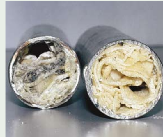
Kalkafzettingen in de leidingen
